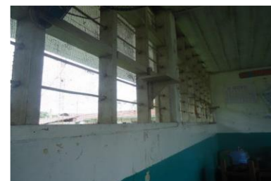
Figura 10. No existe alero posterior, las aguas de lluvia ingresan e inundan las aulas
