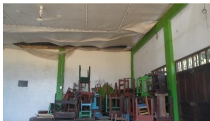
Figura 9. Muros sin confinamientos horizontales ni verticales. No cuenta con viga collar
