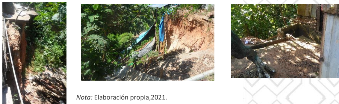
Figura 7. Erosión de las paredes de la cárcava de Muyuna y desembocadura de tuberías de aguas servidas
