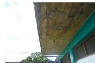
Figura 15. Cielo raso en aleros deteriorado, por goteras, no existe canaleta.
