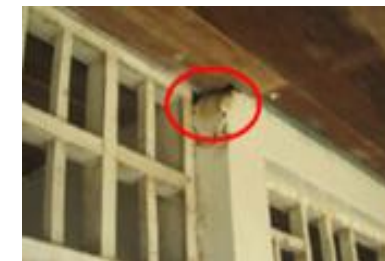
Figura 11. No existe vigas collar, encuentro entre viga y columna deterioradas.
