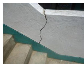
Figura 14. Grieta en baranda de concreto por la antigüedad de la edificación
