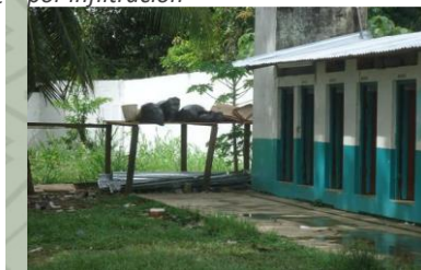
Figura 16. Asentamiento de veredas, por infiltración
