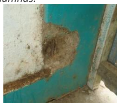
Figura 13. Exposición del acero por erosión del concreto en base de columnas.
