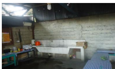
Figura 12. Construcción precaria, muros sin confinamientos verticales ni horizontales.
