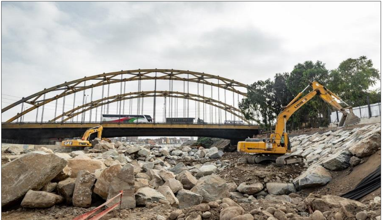
Figura 106. Enrocado del cauce a la altura del puente ejército en Lima.
