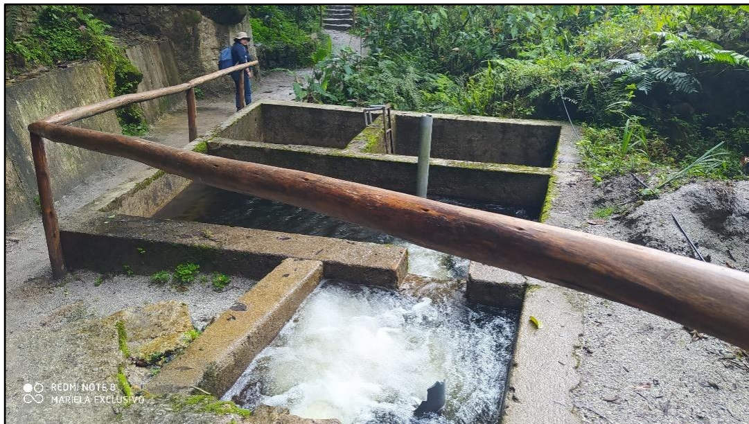
Figura 117. Captación de aguas superficiales.
