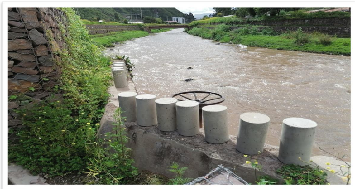
TRASLADO DE PROBETAS CILÍNDRICAS A LA PROGRESIVA 19+840 DEL RIO HUATANAY PARA SU CURADO
