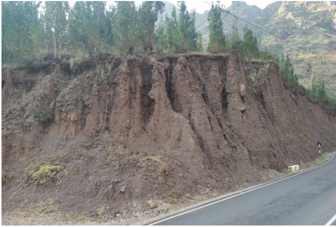
Fotografía 01: Erosión en surco, por aguas pluviales
