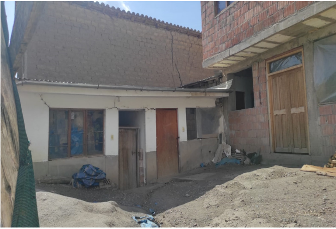
Fotografía 07:Identificación de fisuras en viviendas
