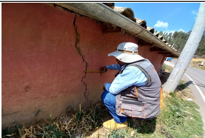
Fotografía 01:Identificación de fisuras en viviendas
