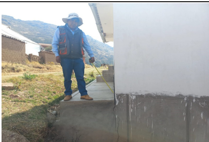
Fotografía 04:Identificación de fisuras en viviendas
