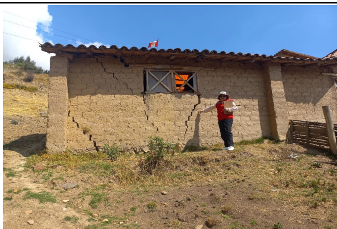
Fotografía 03:Identificación de fisuras en viviendas
