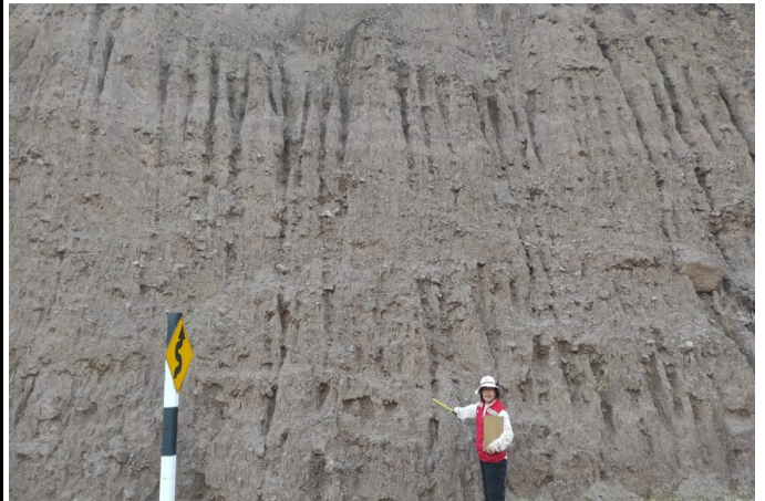
Fotografía 04:km 8+220 Erosión en surco, originada por aguas pluviales
