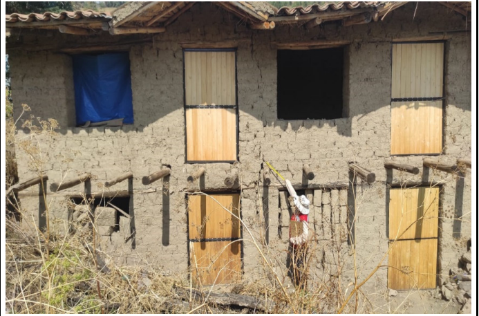
Fotografía 08:Identificación de fisuras en viviendas
