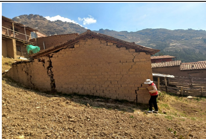
Fotografía 05:Identificación de fisuras en viviendas
