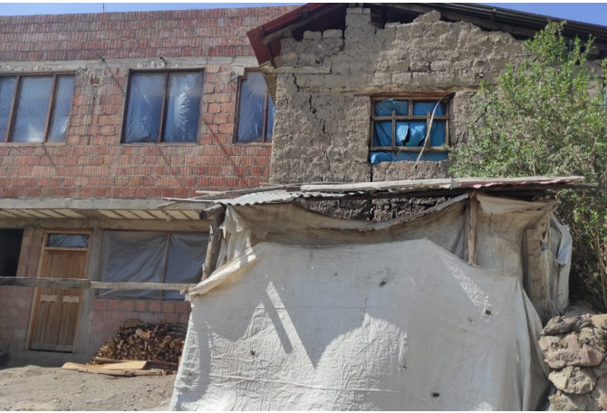
Fotografía 09:Identificación de fisuras en viviendas
