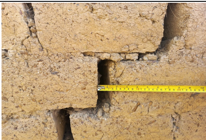
Fotografía 06:Identificación de fisuras en viviendas
