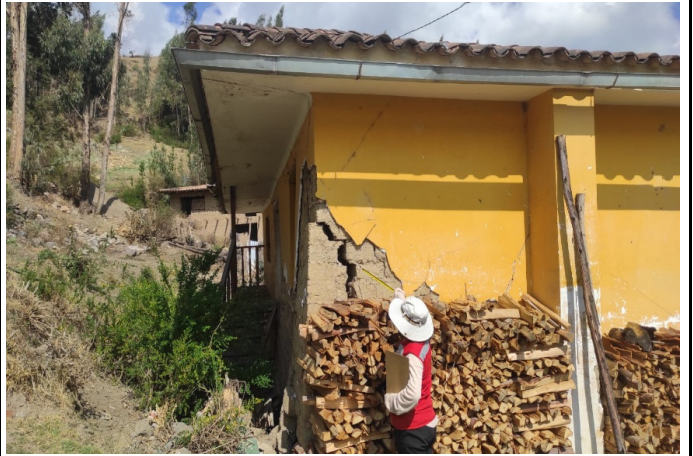
Fotografía 10:Identificación de fisuras en viviendas
