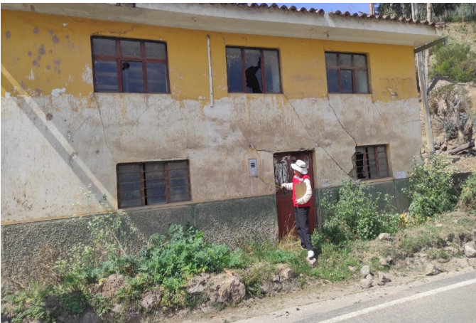
Fotografía 11:Identificación de fisuras en viviendas
