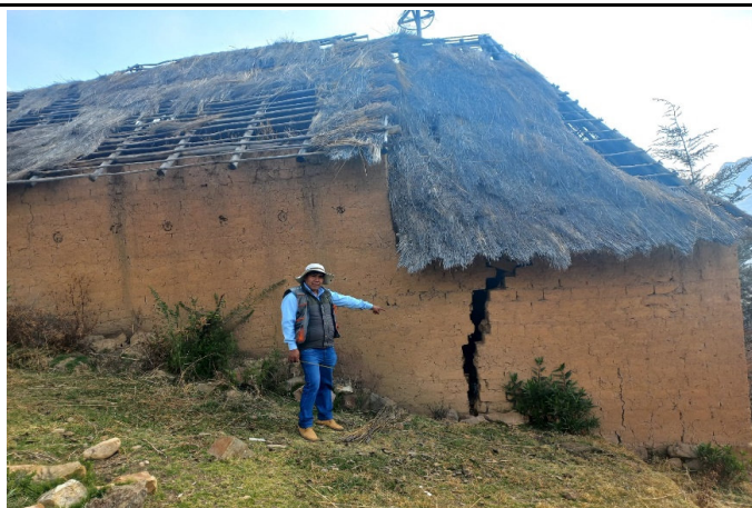
Fotografía 02:Identificación de fisuras en viviendas
