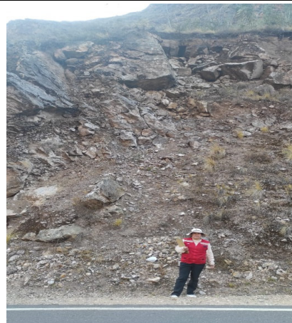
Fotografía 06:km 8+940 Caída de rocas y suelos pertenecientes al Grupo Mitu.
