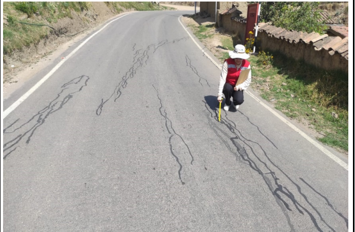
Fotografía 12:Identificación de fisuras en viviendas
