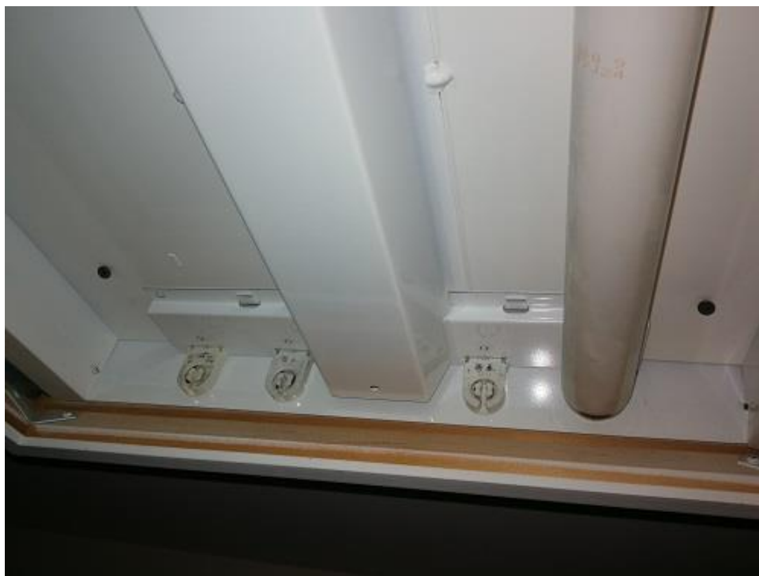
Figura 3.1 Panel fotográfico 1 de los equipos eléctricos utilizados en el instituto.
